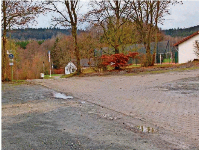
Nach Ansicht der Mehrheit im Gemeinderat bedarf der Wanderparkplatz vor der Schule wegen seines schlimmen baulichen Zustandes dringend einer Generalsanierung. Foto: Dieter Jenß
