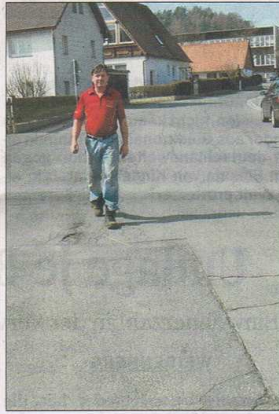
Erhebliche Schäden weisen die Gemeindefraßen in Glashütten auf, wie das Bild von der Schulstraße zeigt. Foto: Jenß
